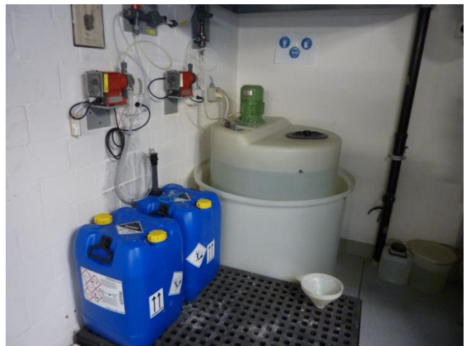
Dosierstation für Schwimmbadchemikalien
