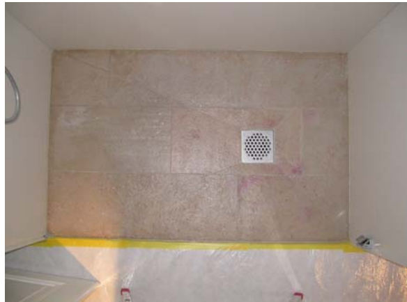
Bild 1: Rotfärbung der Fliesen der Dusche
