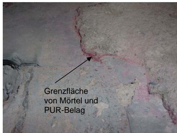
Bild 2: Rotfärbung der unteren Mörtelschicht
